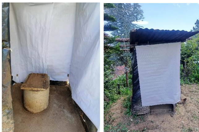
Ilustración 5. Taza y plancha instalada con caseta.
