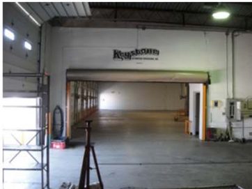
Fire Door Passageway
